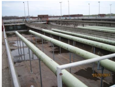
Effluent piping Indiana
